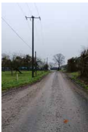
La Couture : réalisation d'un enrobé par l'entreprise Even pour un coût de : 25880,04€
