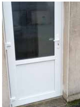
Changement d'une porte de la salle des fêtes par l'entreprise Videloup Gilles pour un coût de 2823,26€.
